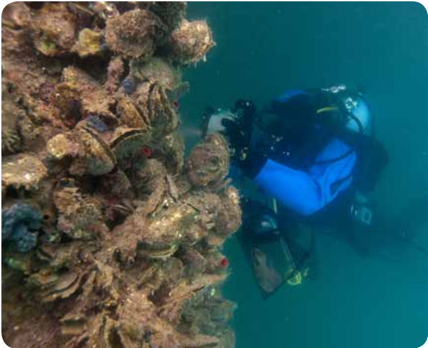
Slika 35: Obrast na stebrih v Luki Koper.
